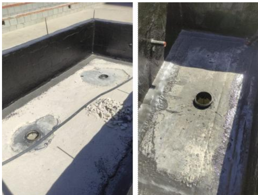
Figura 18 - Proteção inadequada dos tubos de passagem.
