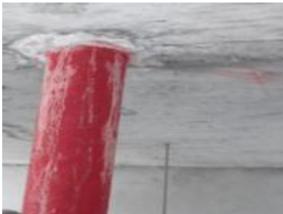
Figura 17 - Surgimento de eflorescência.
