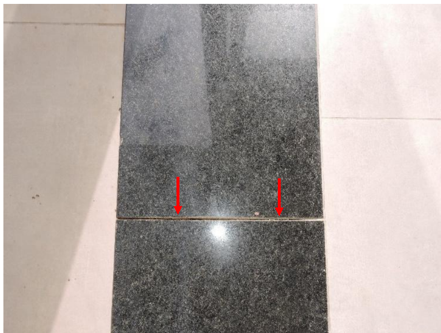
Figura 3 - Ausência de vedação na emenda dos granitos.
