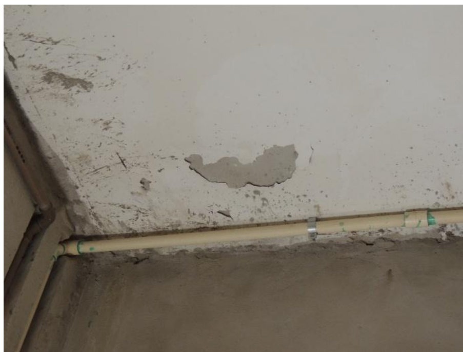
Figura 6 - Umidade e descascamento de pintura.
