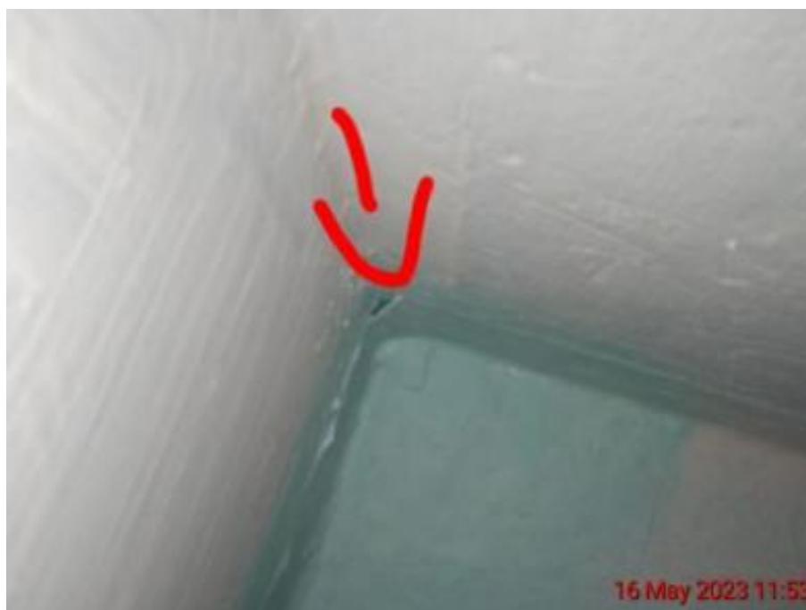
Figura 12 - Excesso de manta na impermeabilização
