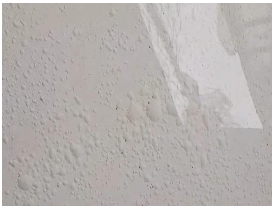
Figura 11 - Impermeabilização executada incorretamente.
