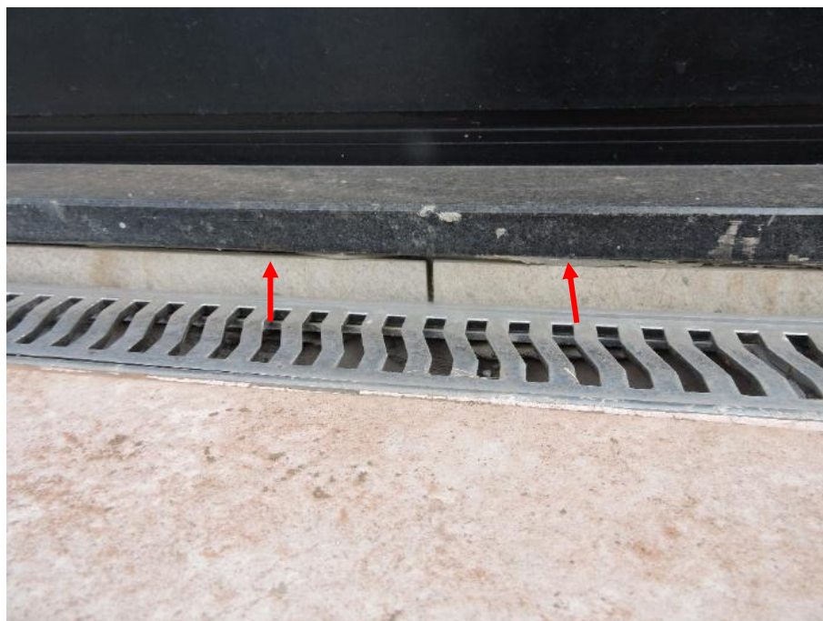
Figura 4 - Ausência de vedação na parte inferior do granito.
