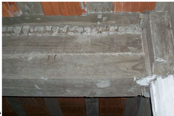
Figura 3 - Falta de adensamento do concreto na viga.
