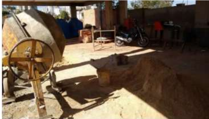
Figura 4 - Materiais armazenados sem nenhuma contenção.
