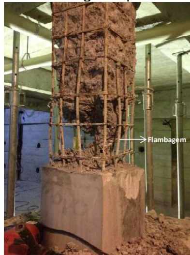
Figura 2 - Flambagem aparente de pilar.
