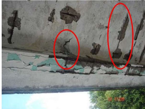
Figura 1 - Rachaduras em viga.
